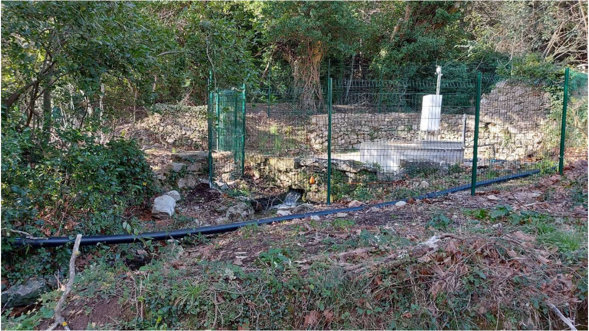
Figure 15. Captage de la source de Font Pétugue le 26 janvier 2023
